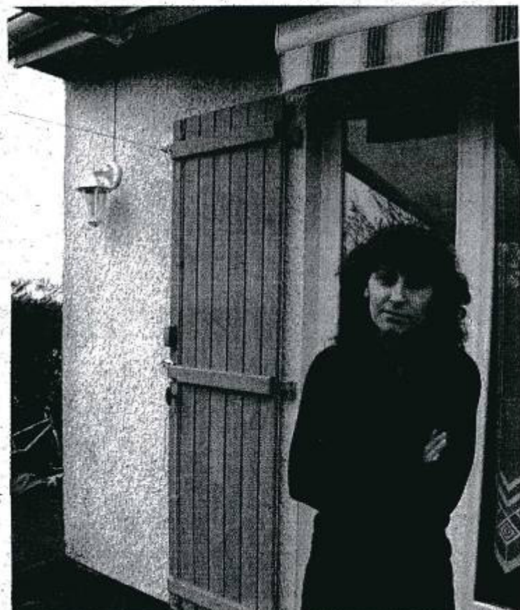
MAGNANVILLE, JEUDI DERNIER. La maison de Nathalie est coupée en deux, la dalle cassée. A force de se gonfler d'eau puis de sécher, la terre a endommagé les fondations du pavillon de la jeune femme.
